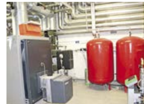
Gasbrenner der Stadtwerke
