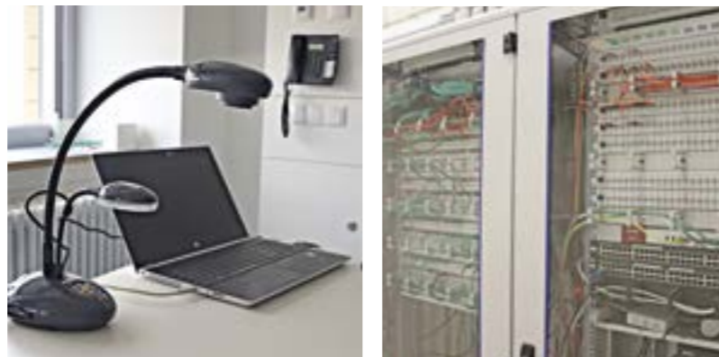
Links: Dokumentenkamera und Laptop. Rechts: EDV-Hauptverteilung
