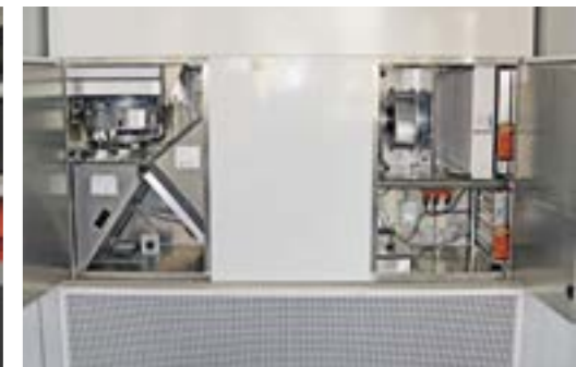
Lüftungsgerät im Klassenzimmer
