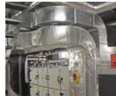
Lüftungsanlage im Untergeschoss
