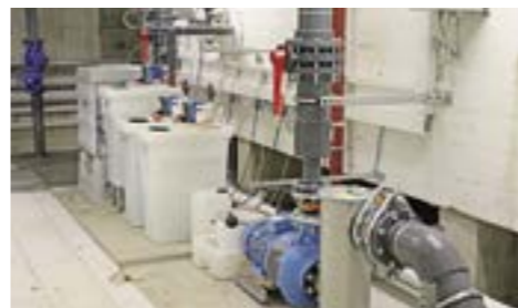
Schwimmbadtechnik im Untergeschoss
