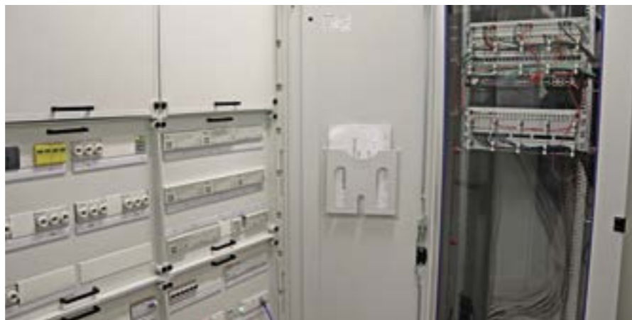
Links: Elektro-Unterverteilung; Rechts: EDV-Unterverteilung
